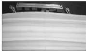
V. Zwolnić uchwyty i zostawić do wystudzenia. Następnie sprawdzić połączenie pod względem ciągłości spoiny i prawidłowego wyrównania kształtów. Jeśli spoina nie spełnia naszych oczekiwań należy powtórzyć operacje I-V. V. Release jig, allow to cool and inspect welded joint for continuity of weld and correct alignment of profiles. If the weld is unacceptable repeat operations I-V.
